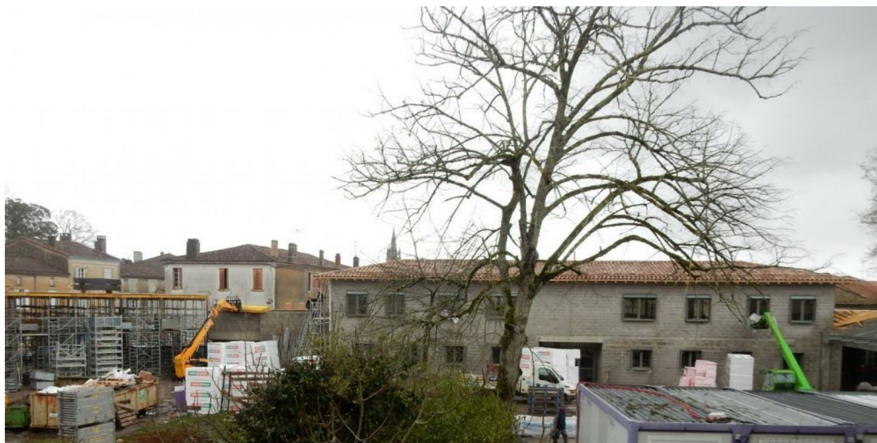
Vue d'ensemble des travaux extérieurs entrepris par la Région Aquitaine au lycée Anatole-de-Monzie. © Photo S. M.
